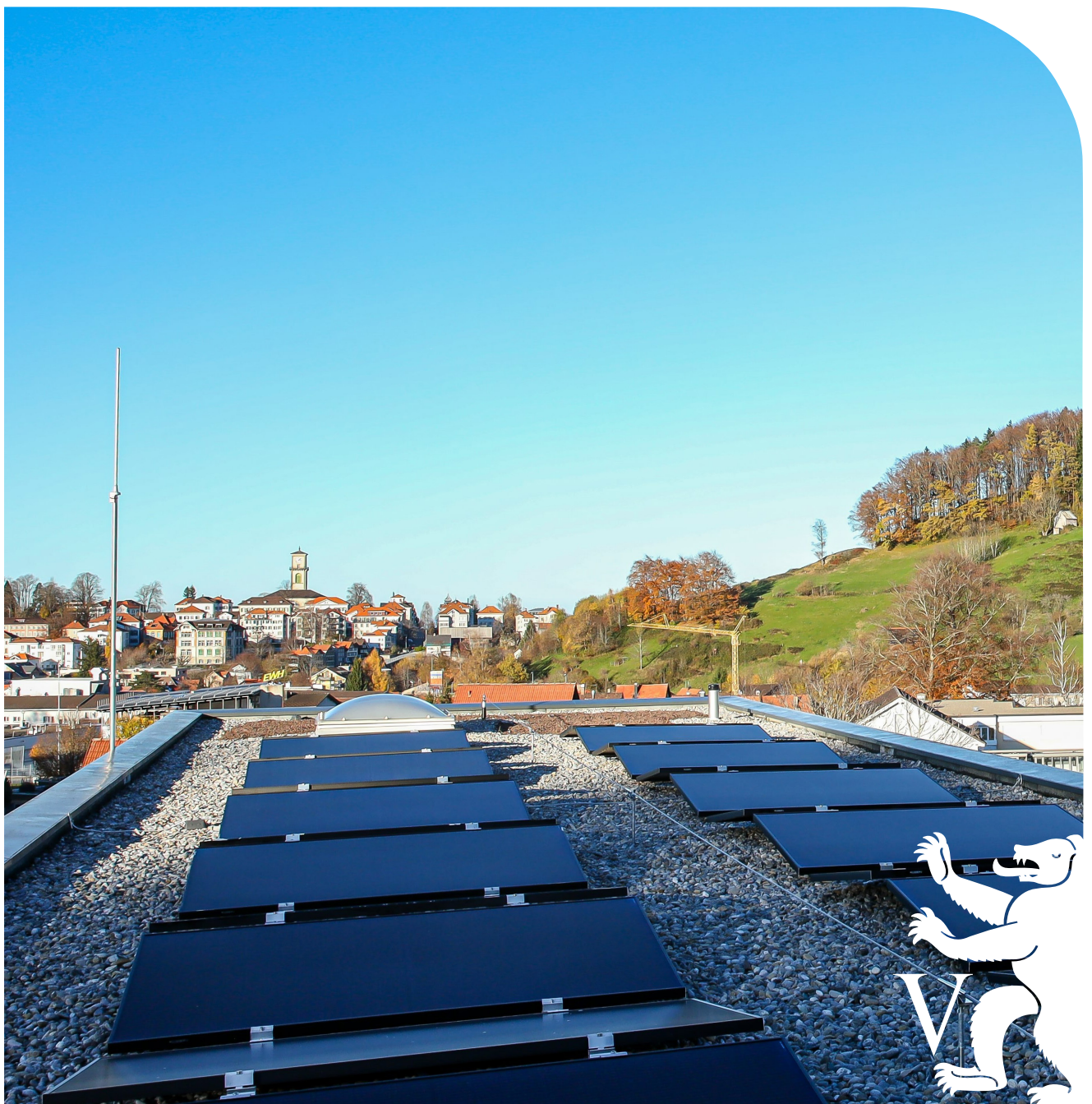
Fotovoltaik-Initiative auf den Dächern der kantonalen Liegenschaften. Wo immer es möglich ist, werden Solarpanels installiert; wie hier auf dem Dach des kantonalen Werkhofs in Heiden. Foto: Tiefbauamt
